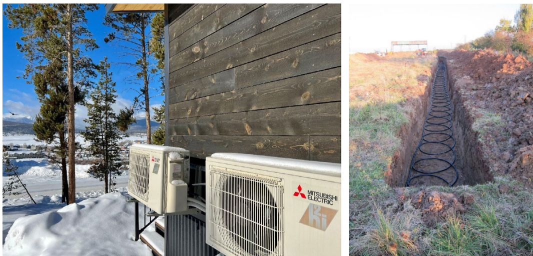
Po lewej: Powietrzne pompy ciepła in situ (zdjęcie dzięki uprzejmości Joe Smyth). Po prawej: Gruntowa pompa ciepła typu Slinky (zdjęcie dzięki uprzejmości David Brooke). Zdjęcia przedrukowane za zgodą.
