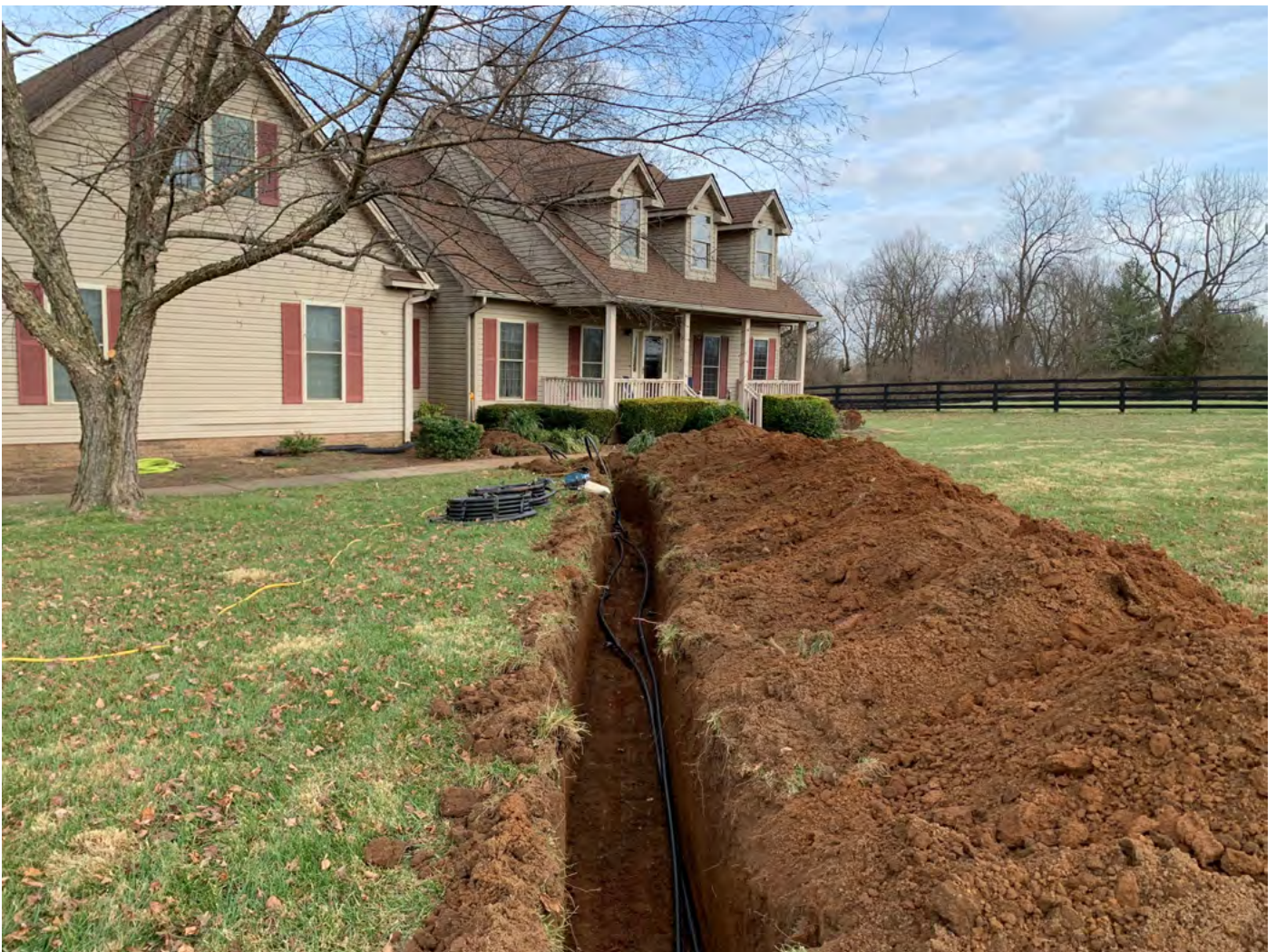
Tranchée pour un réseau de pompes à chaleur géothermiques. Avec l'aimable autorisation de Danielsen_Photography/Shutterstock.
