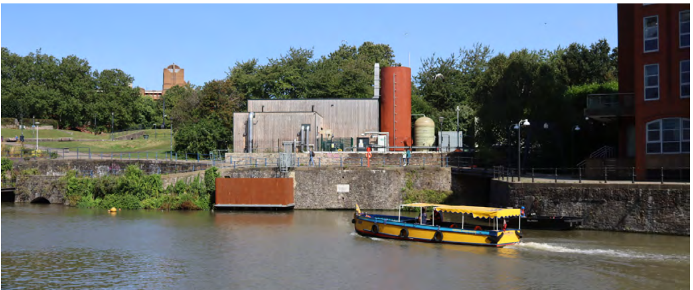
Pompe à chaleur à eau du centre énergétique de Bristol Castle Park. Avec l'aimable autorisation de Star Renewables.
