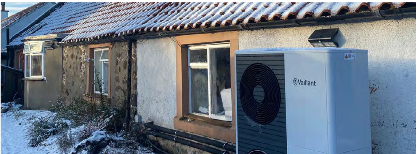
Une pompe à chaleur aérothermique pendant une vague de froid. Avec l'aimable autorisation d'IMS Heat Pumps.
