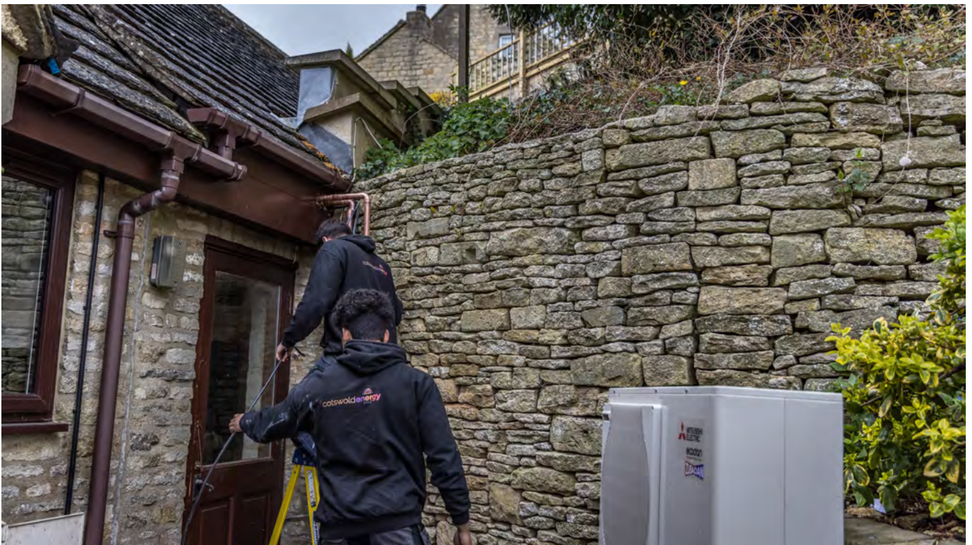
Installation d'une pompe à chaleur aérothermique. Avec l'aimable autorisation de Cotswold Energy Group.
