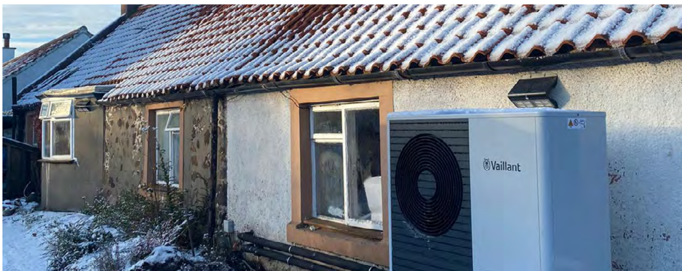
Powietrzna pompa ciepła w czasie fali chłódów. Zdjęcie dzięki uprzejmości IMS Heat Pumps.
