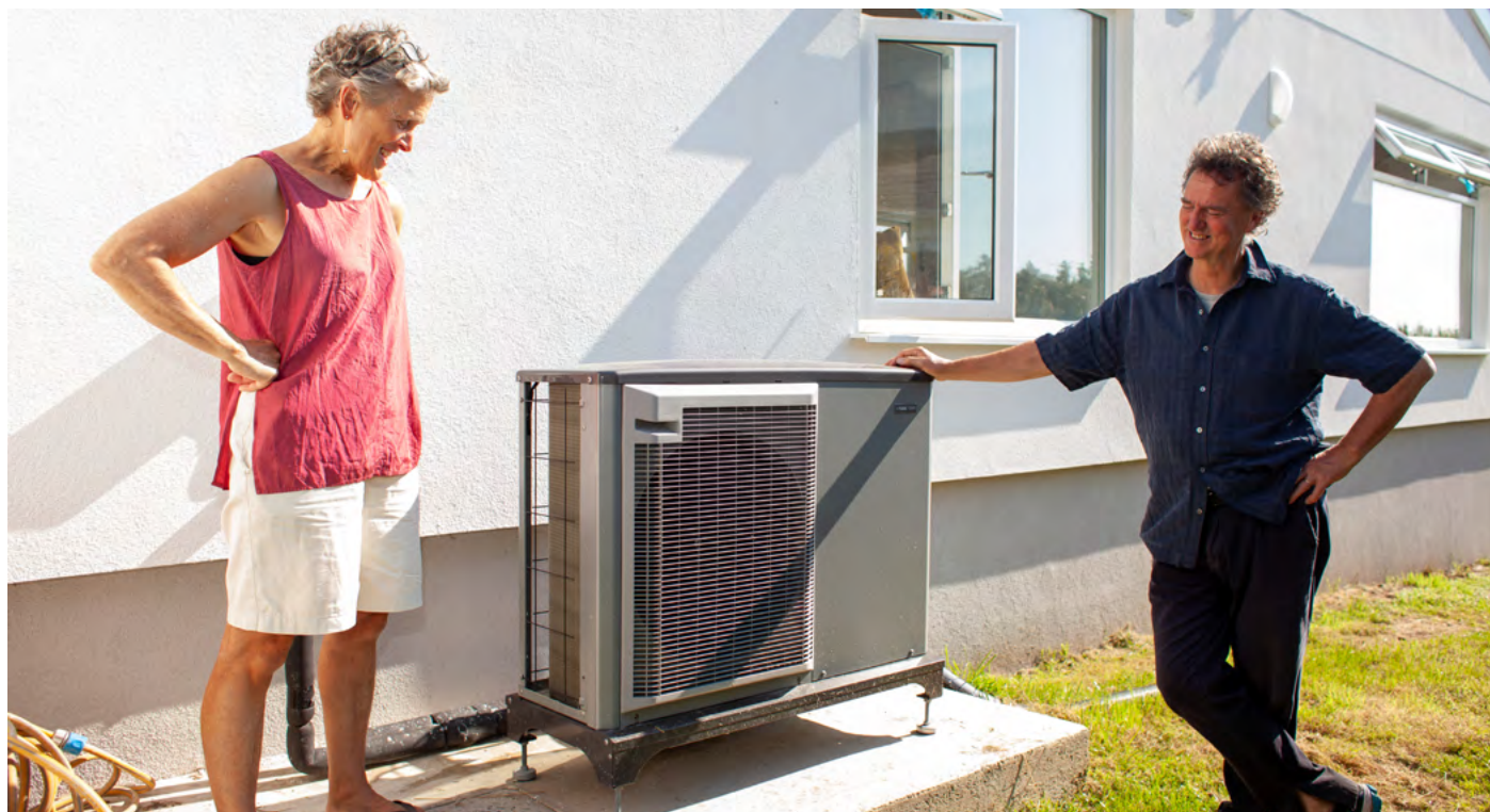
Domowa powietrzna pompa ciepła. Zdjęcie dostarczone przez Jonathana Atkinsona, aka @lowwintersun.
